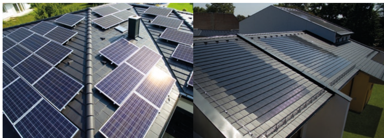
Klaičen solarni sistem s velikimi paneli.
